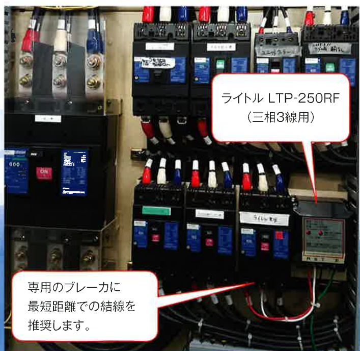
工場配電盤への設置例
