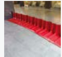
複合ビルへの浸水対策設置例
